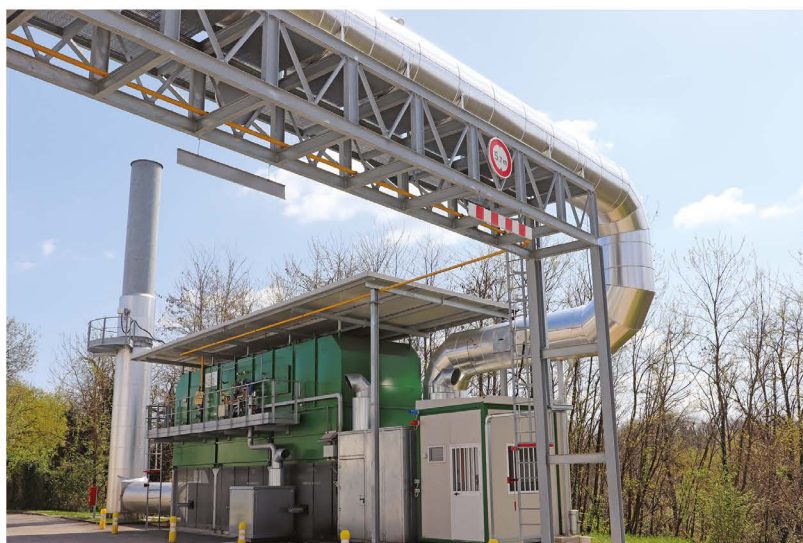
L'incinérateur traite les fumées issues de l'enduction et de la thermo-fixation, qui sont collectées sur le toit. Il est dimensionné pour de futurs agrandissements.
